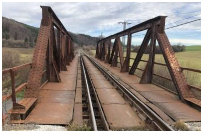
Obr.1 Most s celoplošnou miernou koróziou
